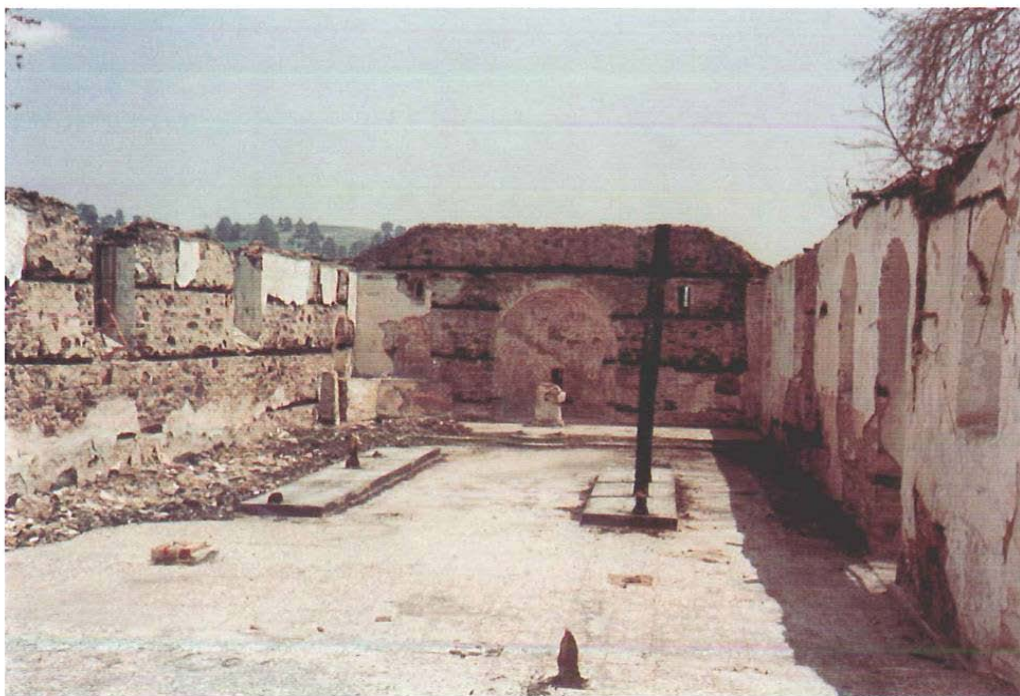
Ε.18.01. Σμίξη, Άγιος Νικόλαος, εσωτερική άποψη μετά την καταστροφή του 1989
