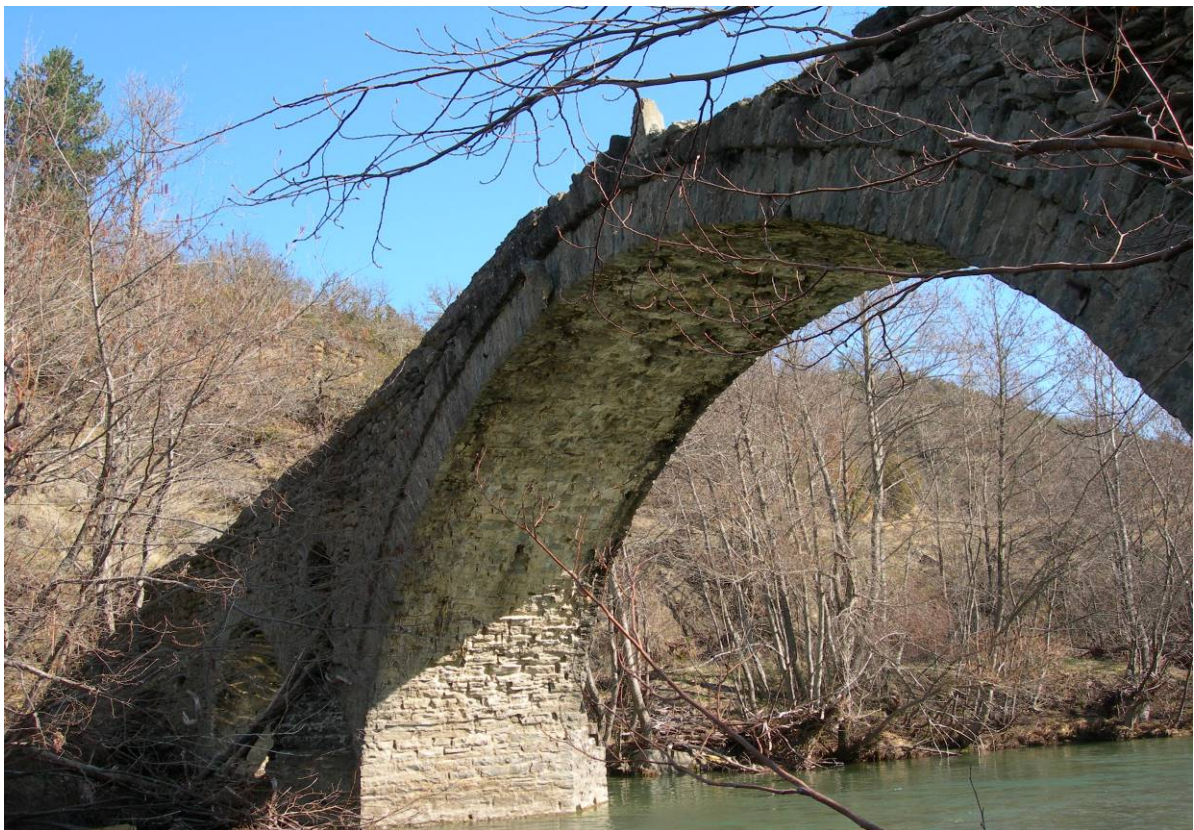
Γ.03.11. Απώλεια λιθοσώματος και κονιάματος δόμησης στο κατάστρωμα από επιρροή ομβρίων
