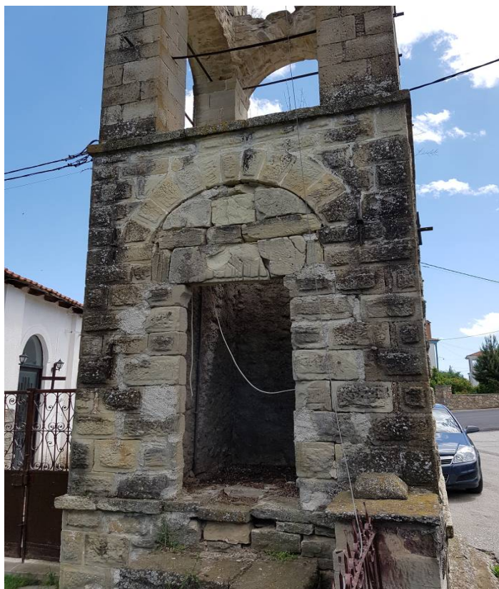
Ε.07.06. Κωδωνοστάσιο. Κατά μήκος ρωγμές στα κονιάματα χαμηλά
