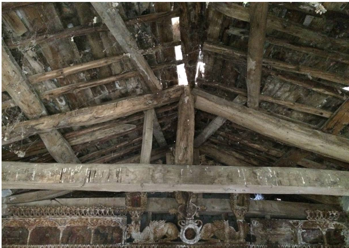
Ε.25.01. Αποσαθρωμένη στέγη
