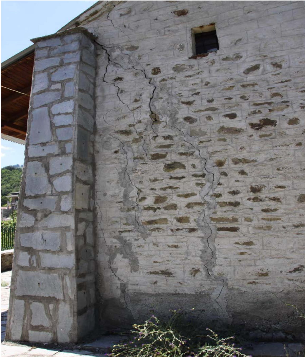
Ε.19.01. Κατακόρυφες ρωγμές στον ανατολικό τοίχο στη θέση του νεώτερου υποστυλώματος
