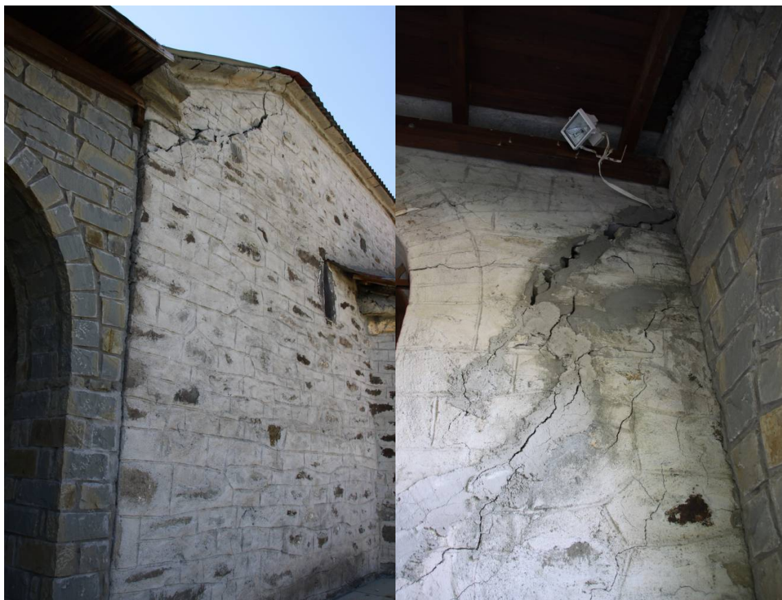
E.18.06., E.18.07. Ρηγμάτωση άνω, στη νοτιοανατολική γωνία
