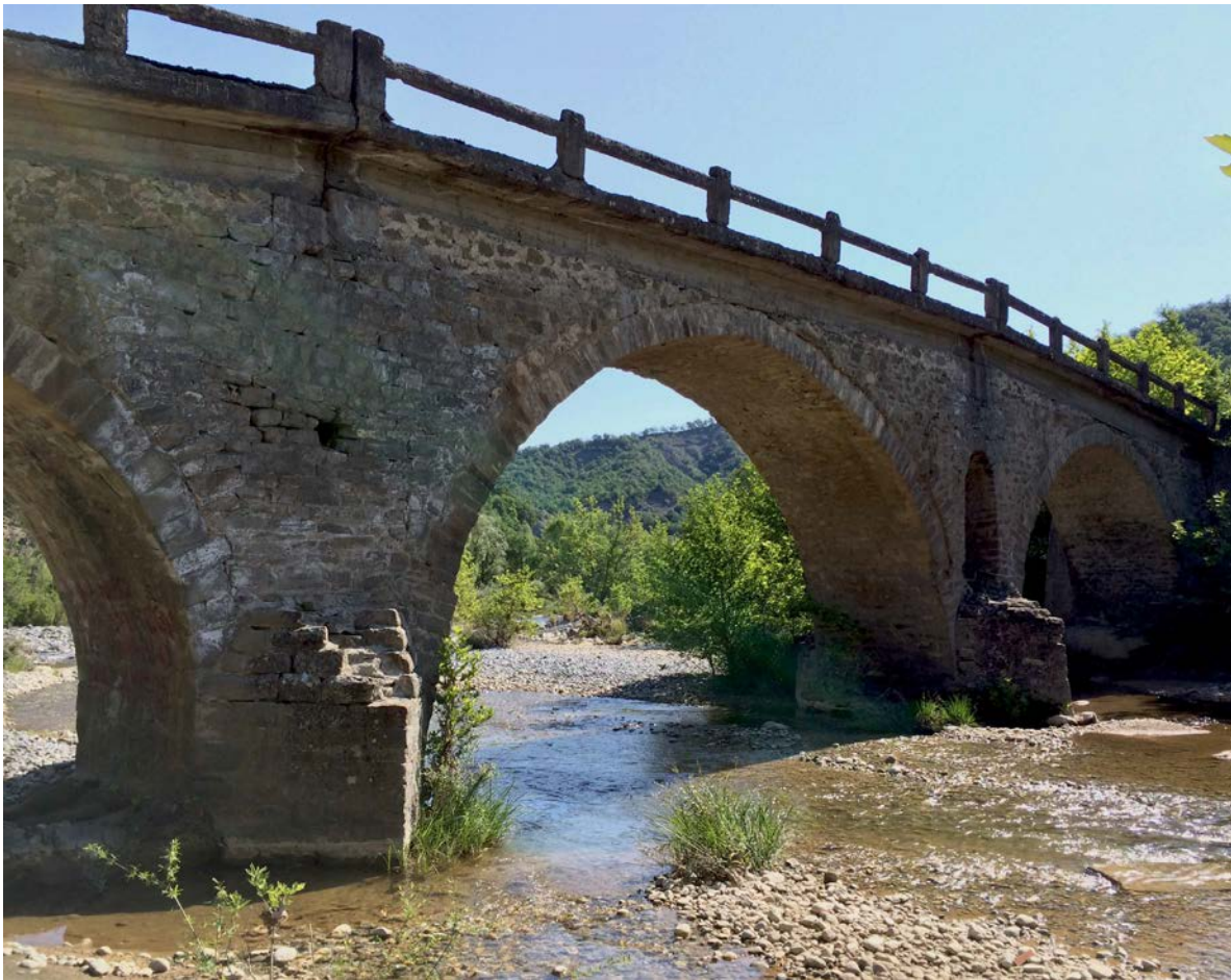
Γ.05.03. Αποσάθρωση εμβόλων μεσοβάθρων
