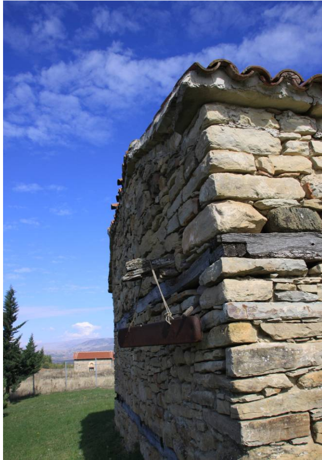
Ε.08.03. Φούσκωμα δυτικής τοιχοποιίας
