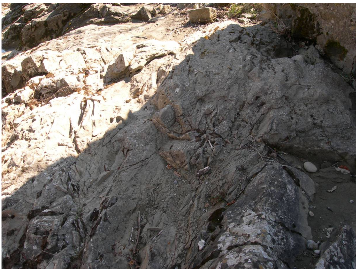
Γ.03.07. Αποσάθρωση βράχου νότιου πρανούς
