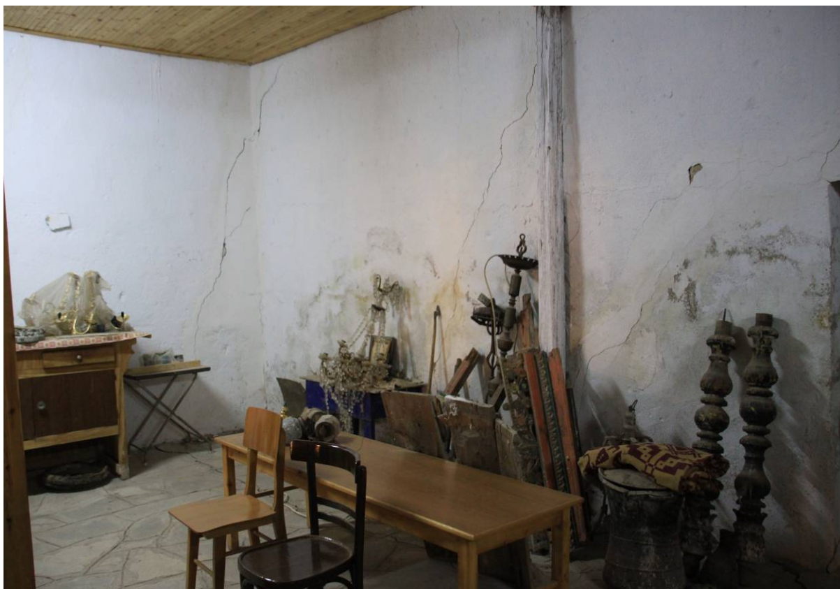
Ε.10.09. Υγρασία στη δυτική πλευρά του ναού
