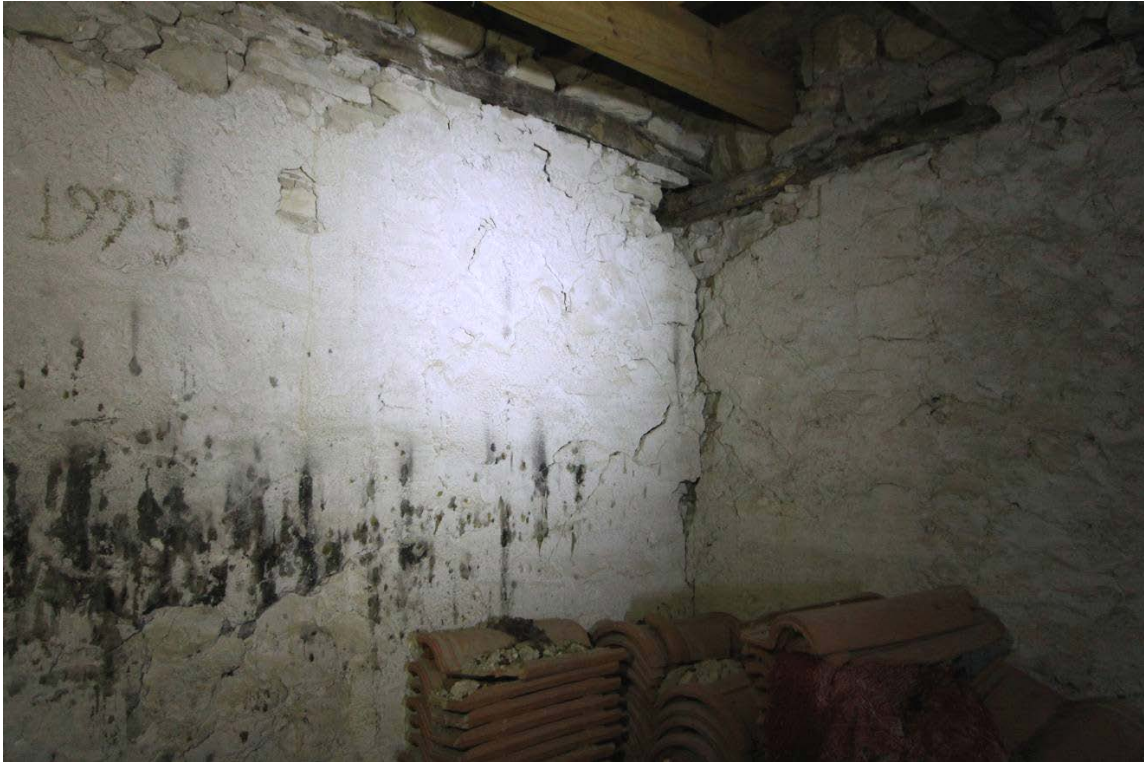
Ε.21.03. Απώλεια συναρμογής περιμετρικών τοίχων (νότιοδυτική γωνία)
