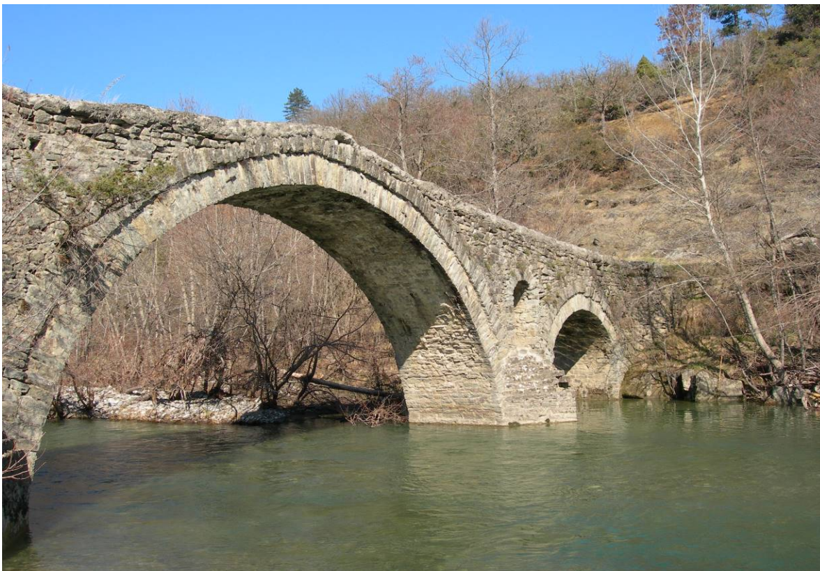
Γ.03.12. Απώλεια λιθοσώματος και κονιάματος δόμησης στο κατάστρωμα από επιρροή ομβρίων
