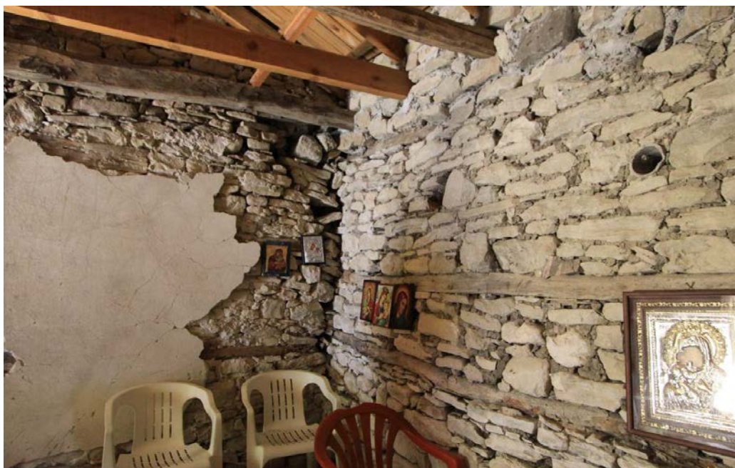
E.21.02. Κατακόρυφες ρηγματώσεις στις θέσεις συναρμογής μεσότοιχου – περιμετρικών τοίχων
