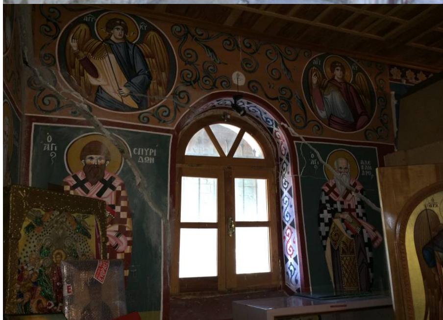
Ε.18.02., Ε.18.03. Διαγώνια διαμπερής ρωγμή στο νότιο τοίχο
