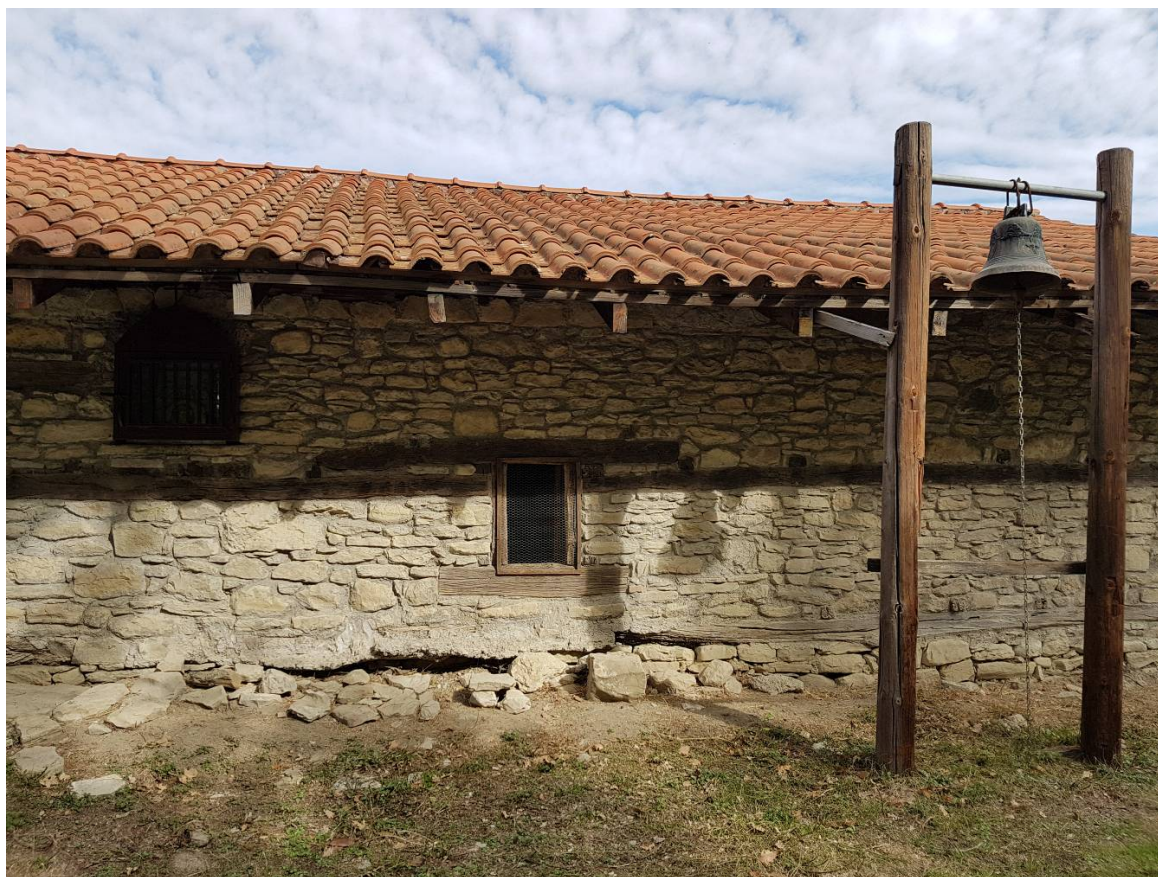
Ε.21.07. Αποκόλληση λίθων - απόπλυση συνδετικού κονιάματος στον πόδα του νότιου τοίχου
