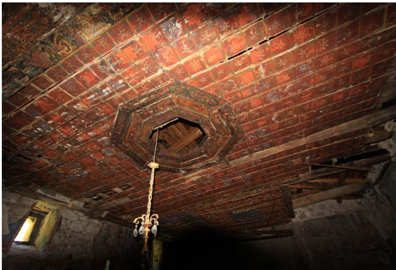
E.27.03. Το εσωτερικό ταβάνι του ναού σε άσχημη κατάσταση
