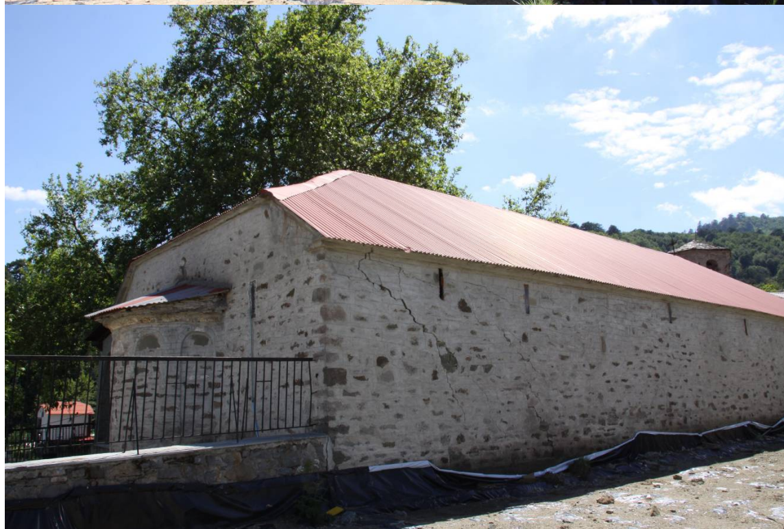
E.18.04, E.18.05. Ρηγματώσεις στο βόρειο τοίχο και υπό κατασκευή έργα αποστράγγισης υδάτων κατά μήκος αυτού
