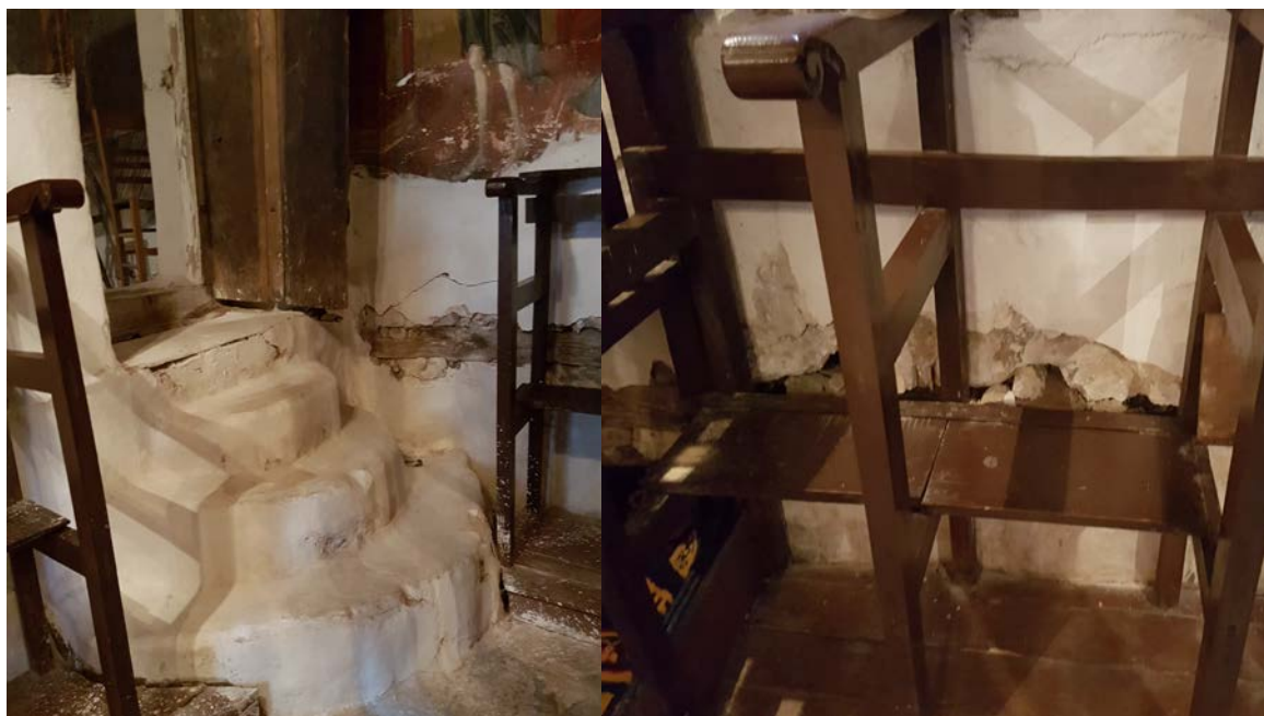
Ε.01.13. Ρηγματώση στο νότιο και βόρειο τοίχο κατά μήκος των ξυλοδεσιών
