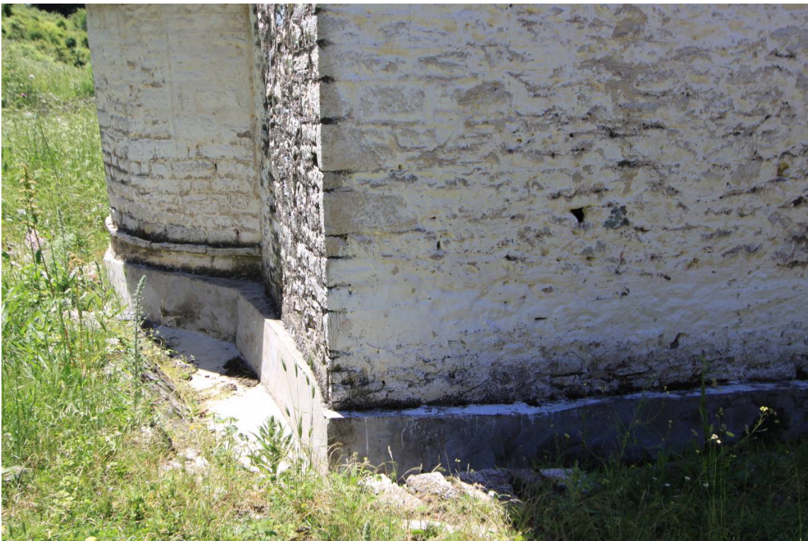
Ε.24.08. Περιμετρικό τοιχάκι, πρόσφατη κατασκευή, για την προστασία από την ανοδική υγρασία
