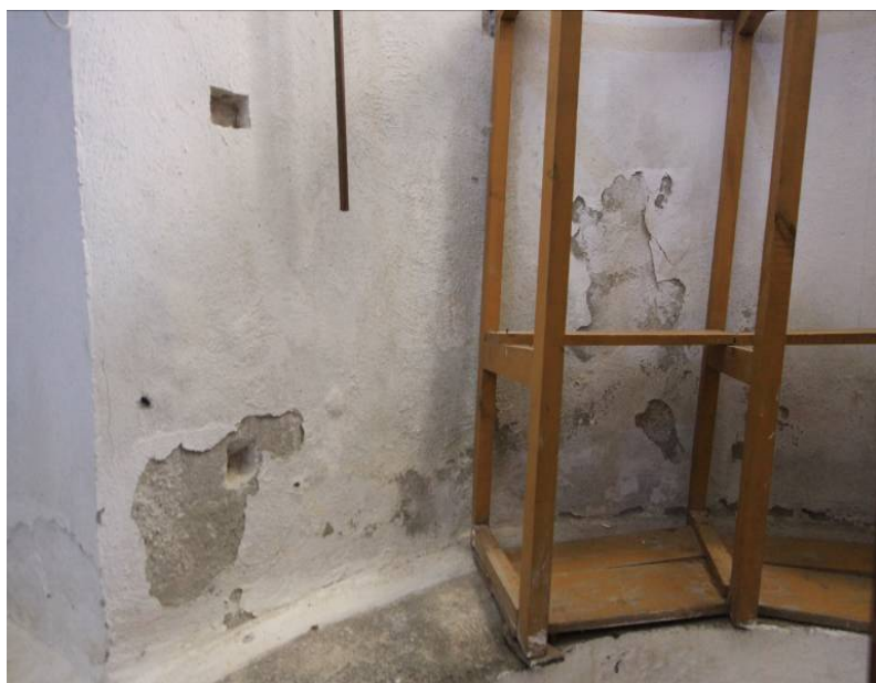
Ε.24.06. Εμφάνιση υγρασίας στη νότια κόγχη του Ιερού
