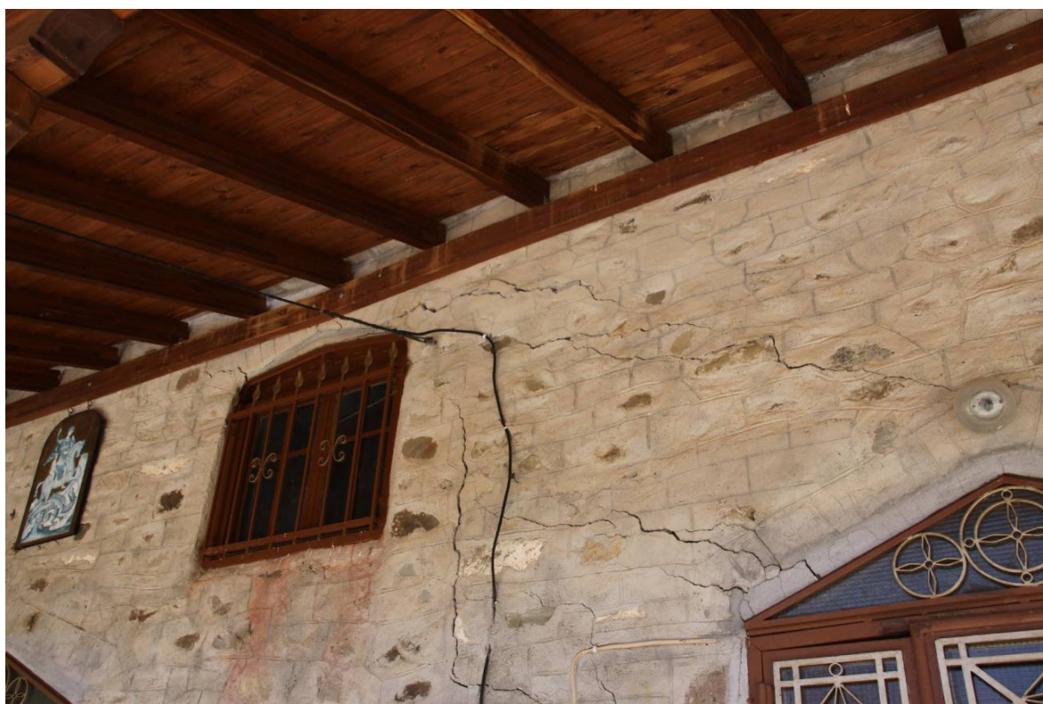
Ε.19. 04. Ρωγμές στο νότιο τοίχο
