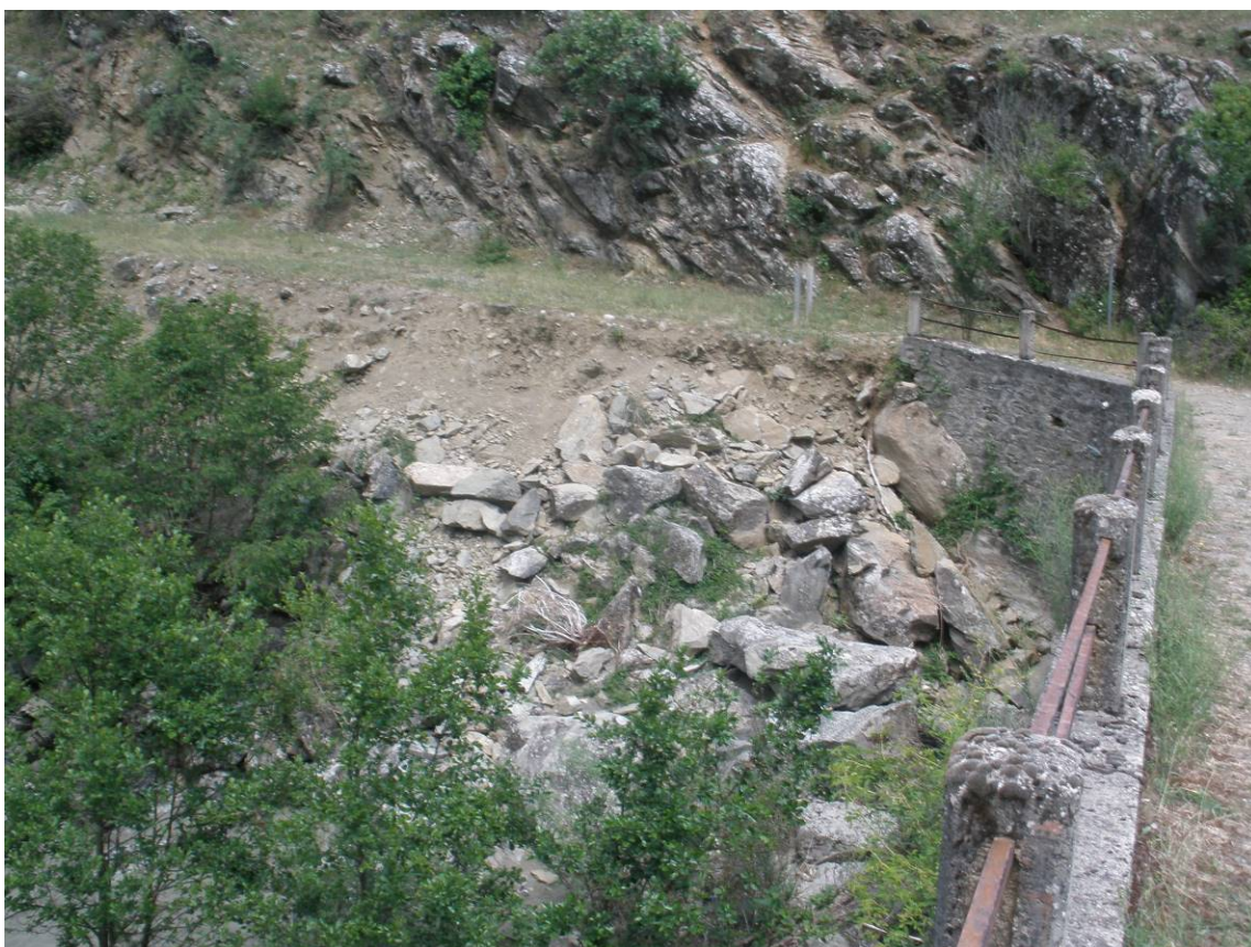
Γ.02.02. Άποψη πρανούς που ολισθαίνει
