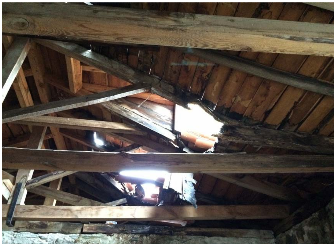
Ε.30.04. Λεπτομέρεια καταστροφής του φεγγίτη της στέγης
