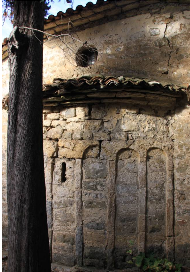
Ε.01.11. Κατακόρυφη ρηγμάτωση στον ανατολικό τοίχο – φαίνεται ότι ο τοίχος στη κόγχη του Ιερού «ανοίγει»
