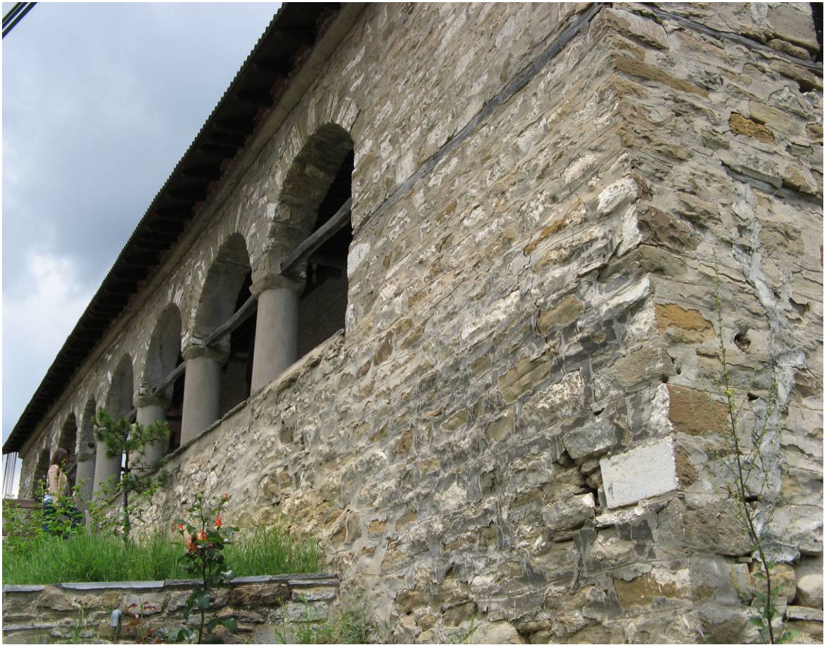
Ε.16.05. Αποκόλληση λίθων στη νοτιοανατολική γωνία
