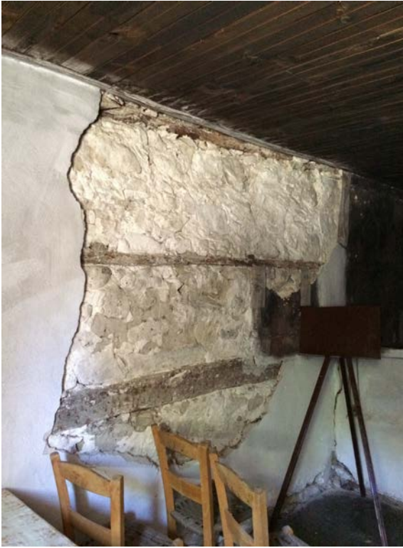
Ε.29.04. Αποσάθρωση κονιάματος
