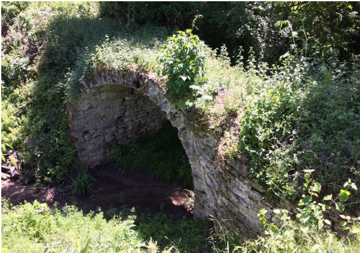
Γ.06.01. Γενική ΒΔ άποψη. Βλάστηση και υποσκαφή θεμελίου
