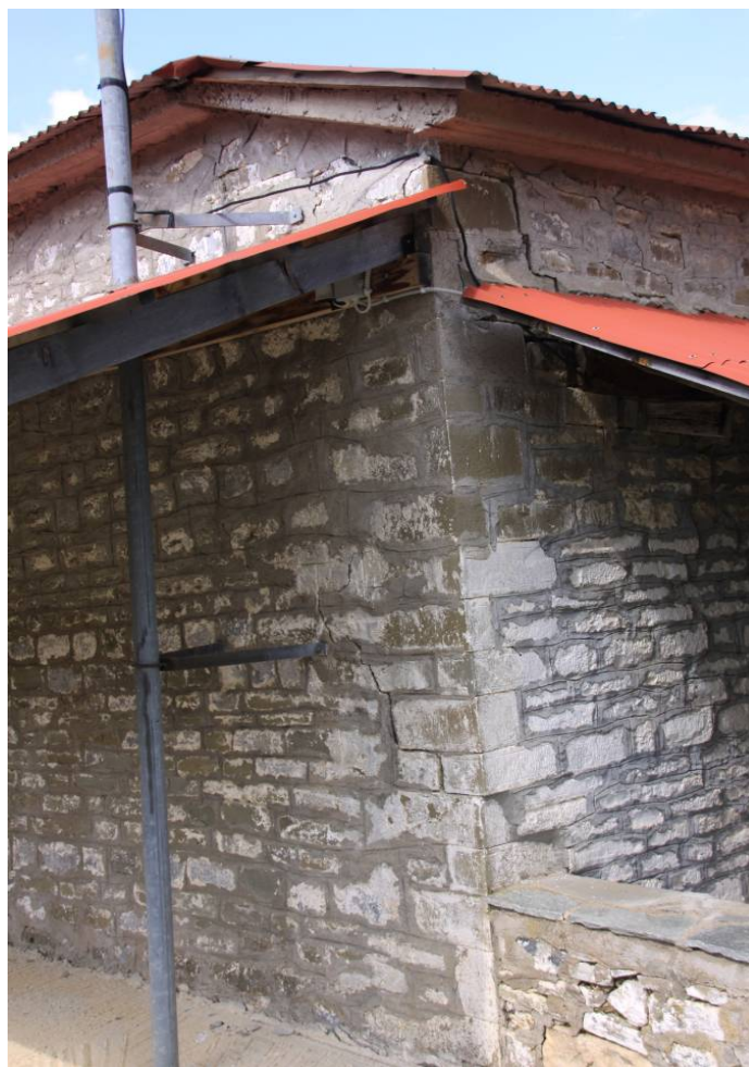
Ε.10.05. Ρηγματώσεις στο δυτικό τοίχο
