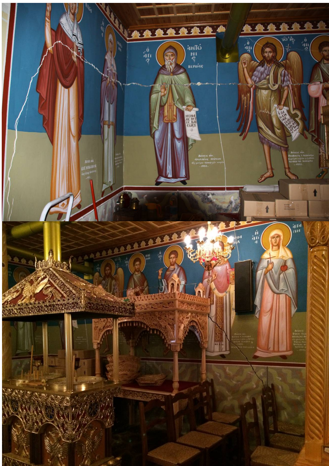
Ε.18.08., Ε.18.09. Οριζόντια ρηγμάτωση σε τμήμα του βόρειου & δυτικού τοίχου
