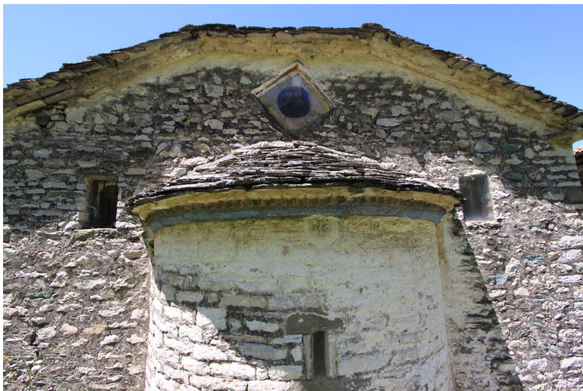
Ε.24.05. Μερική απόπλυση και αποσάθρωση συνδετικού κονιάματος στον ανατολικό τοίχο
