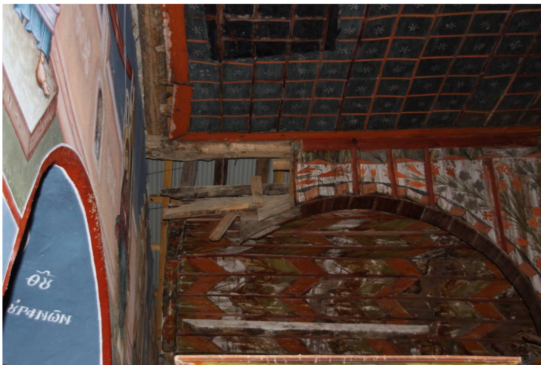
Ε.12.04. Αποσάθρωση στο ταβάνι στο Ιερό του ναού
