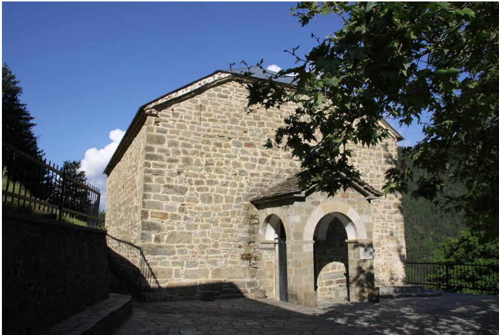
E.13.04. Υγρασία στην δυτική όψη
