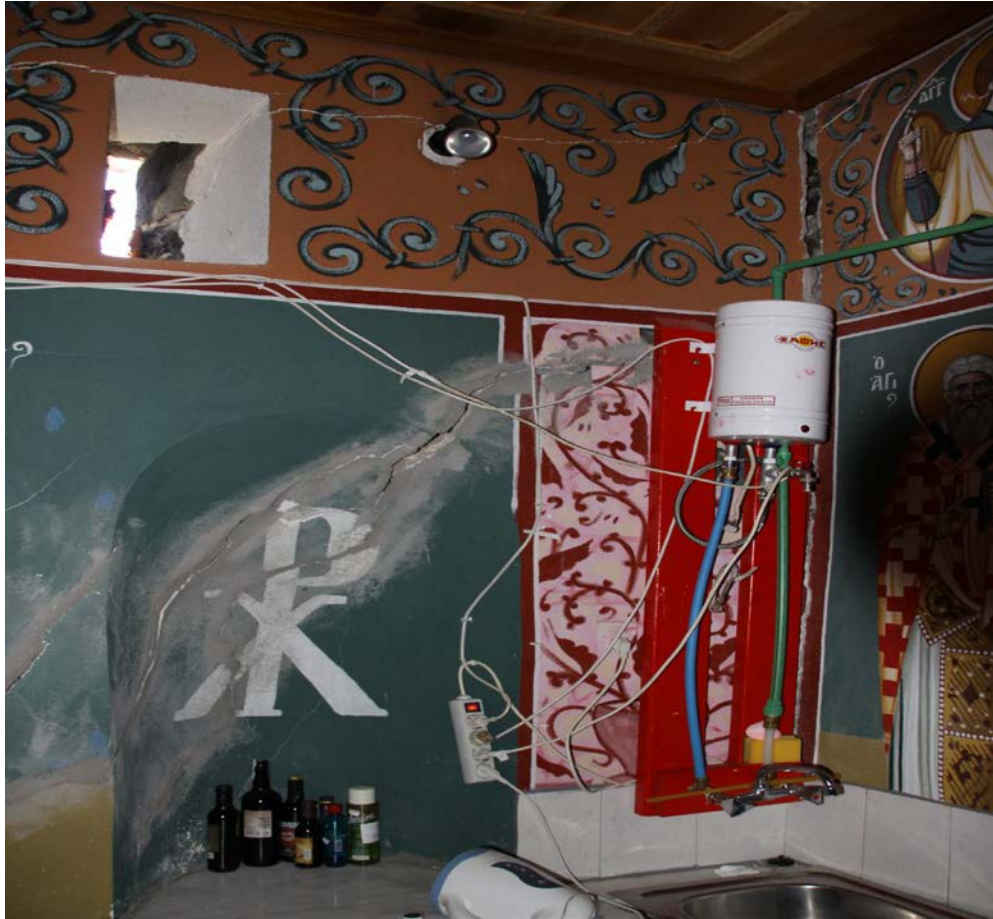
Ε.18.10. Κατακόρυφη ρωγμή στη θέση συναρμογής βόρειου και ανατολικού τοίχου
