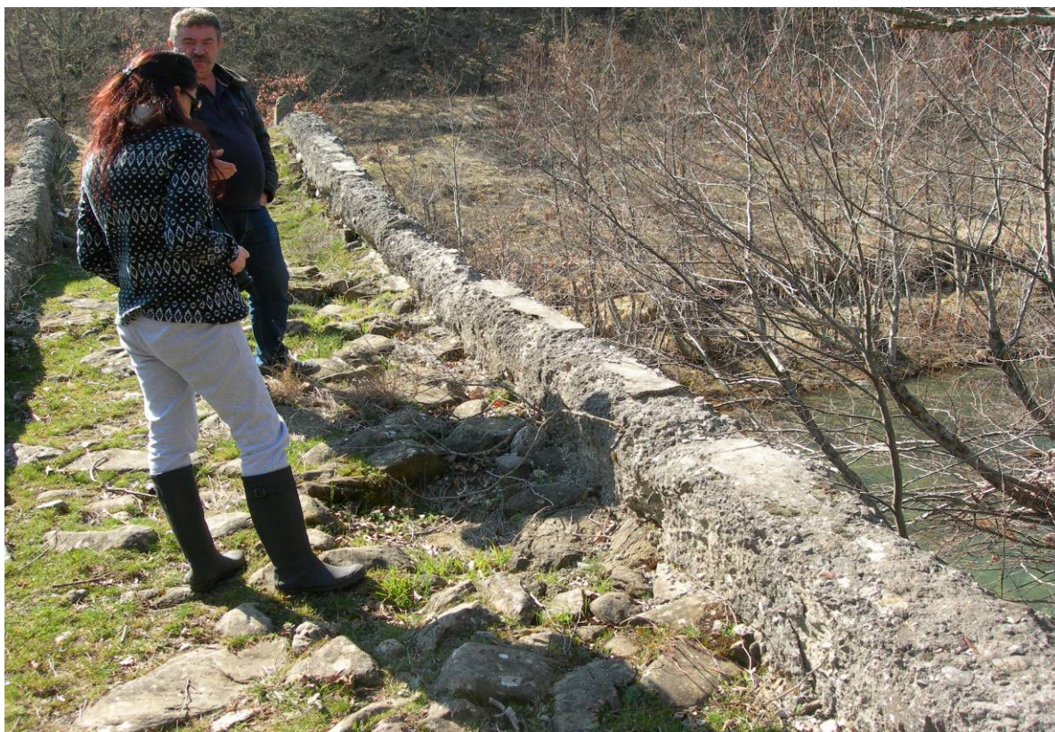
Γ.03.09. Απώλεια λιθοσώματος και κονιάματος δόμησης στο κατάστρωμα
