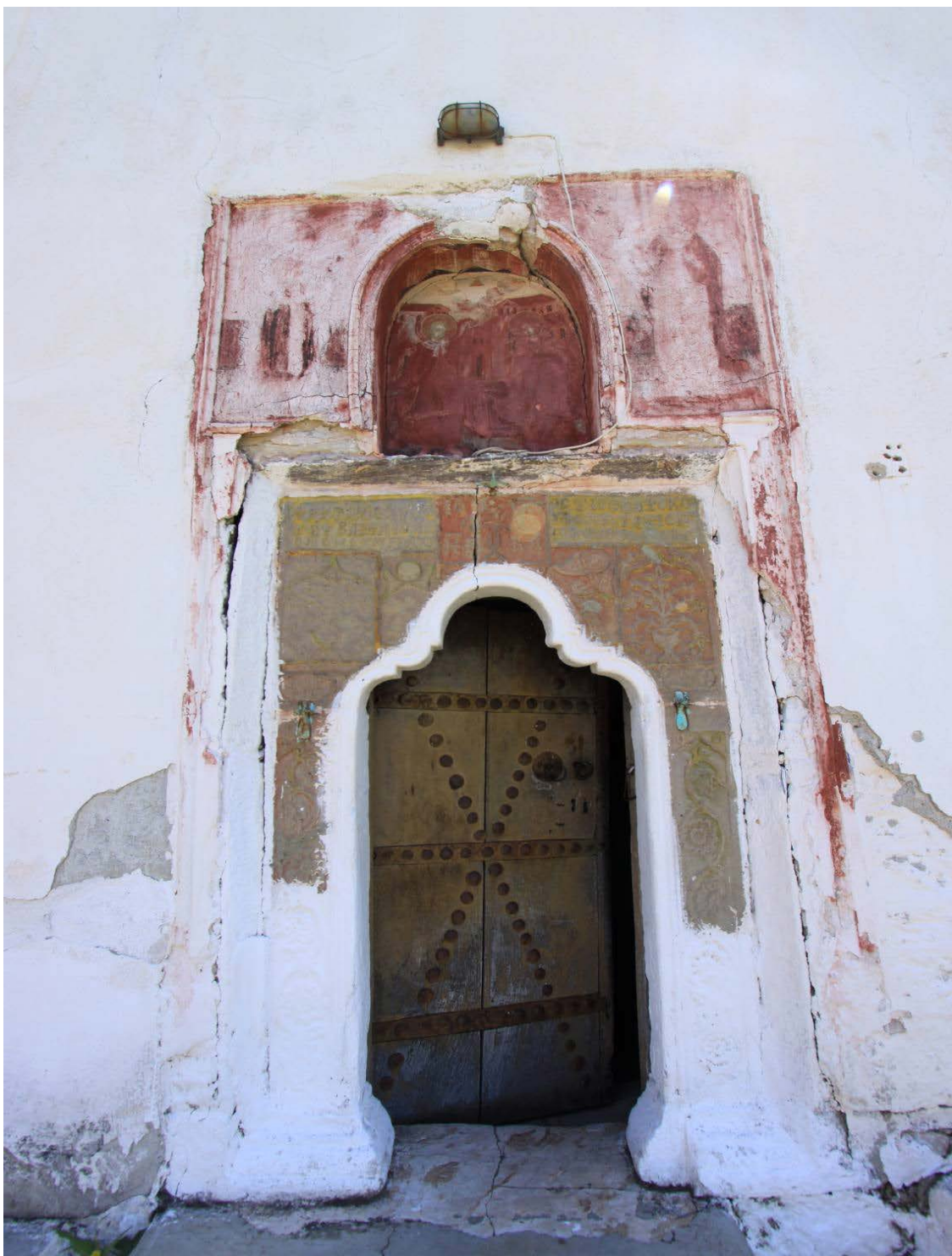
Ε.24.04. Ρηγματώσεις στο λιθανάγλυφο, στο ανωκάσι και του λαμπάδες της θύρας εισόδου
