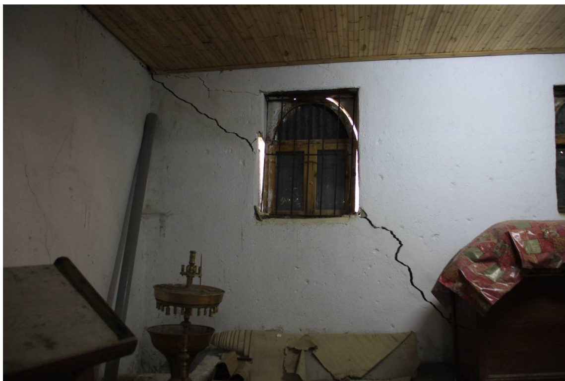
Ε.10.06. Ρηγματώσεις στο εσωτερικό του ναού
