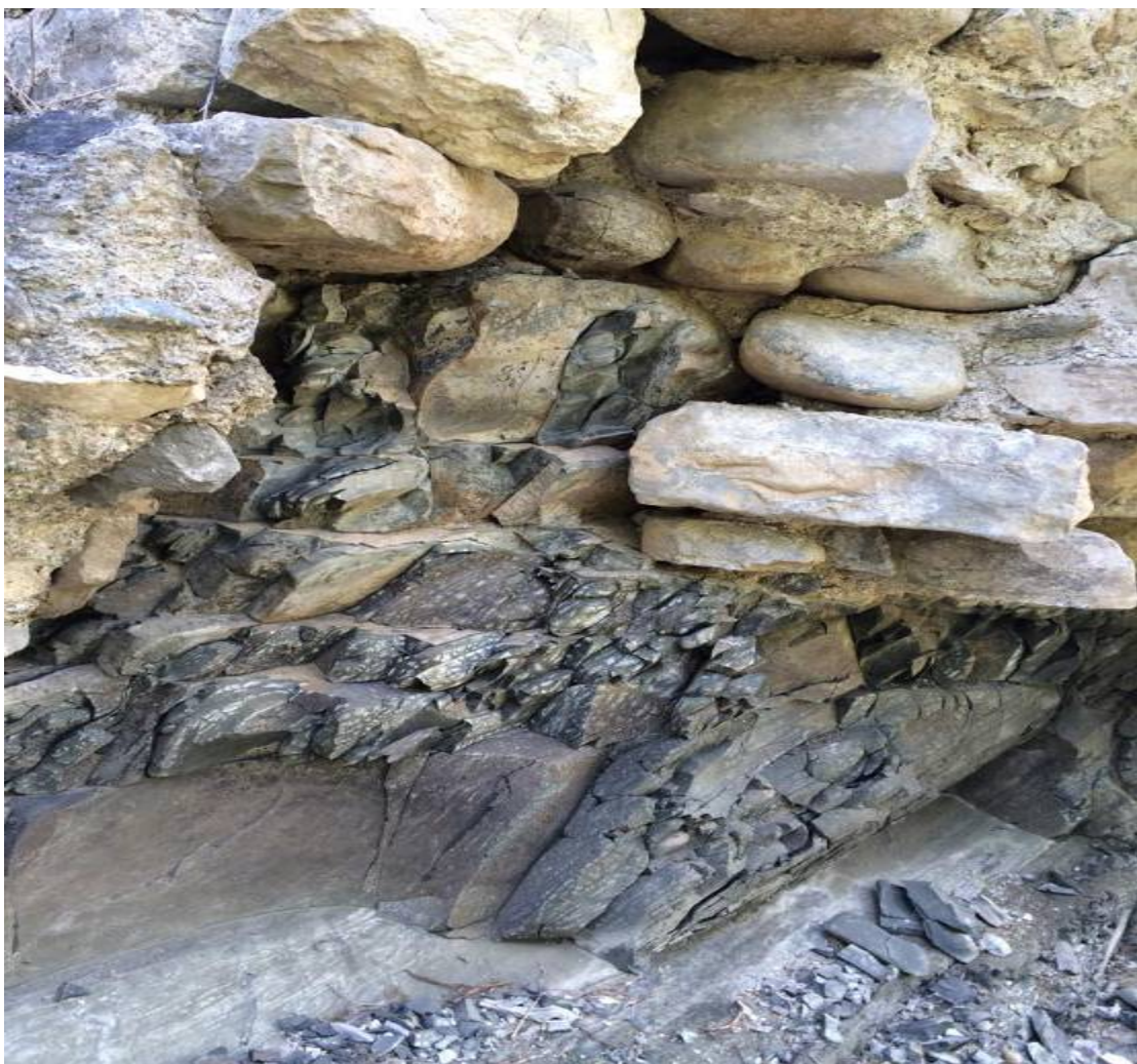
Γ.07.01. Αποσάθρωση βράχου επί του οποίου εδράζεται το δυτικό ακρόβαθρο
