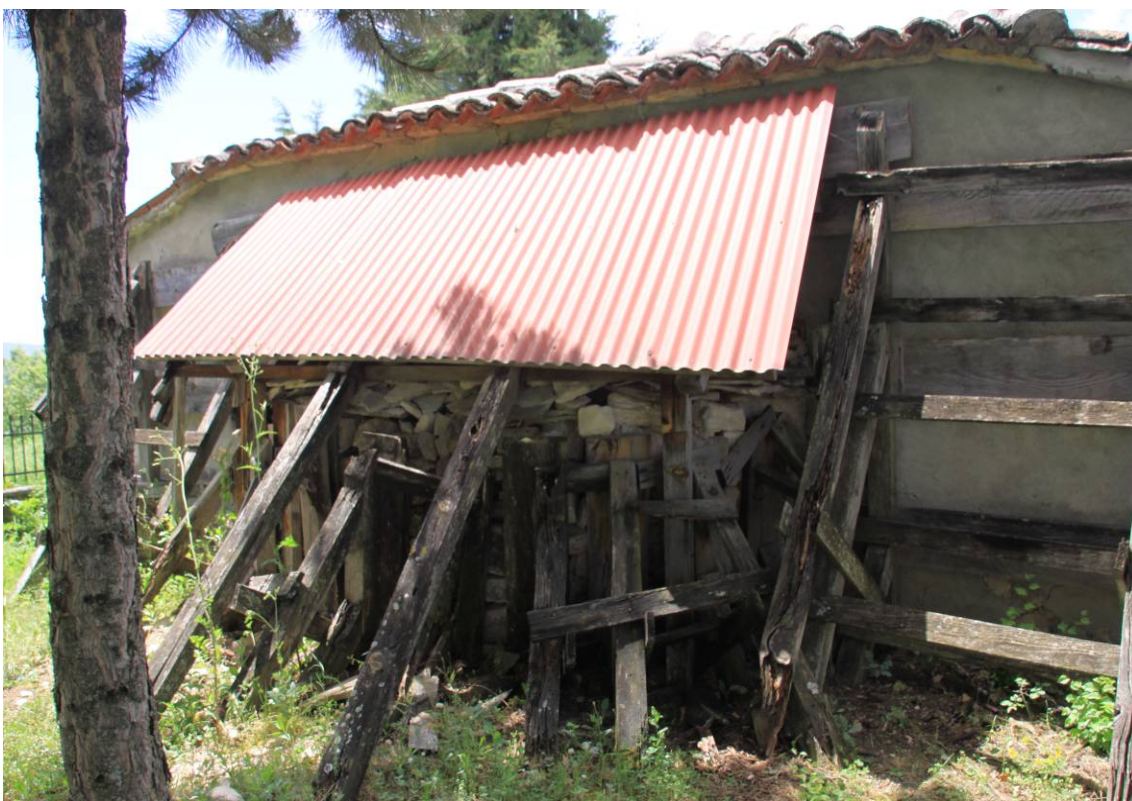
Ε.03.02. Κατάρρευση ιερού και προσωρινές αντιστηρίξεις
