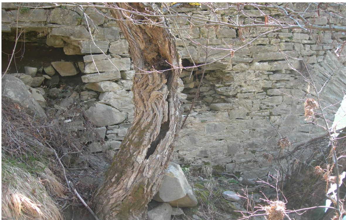
Γ.03.03. Αποσάθρωση βόρειου πρανούς
