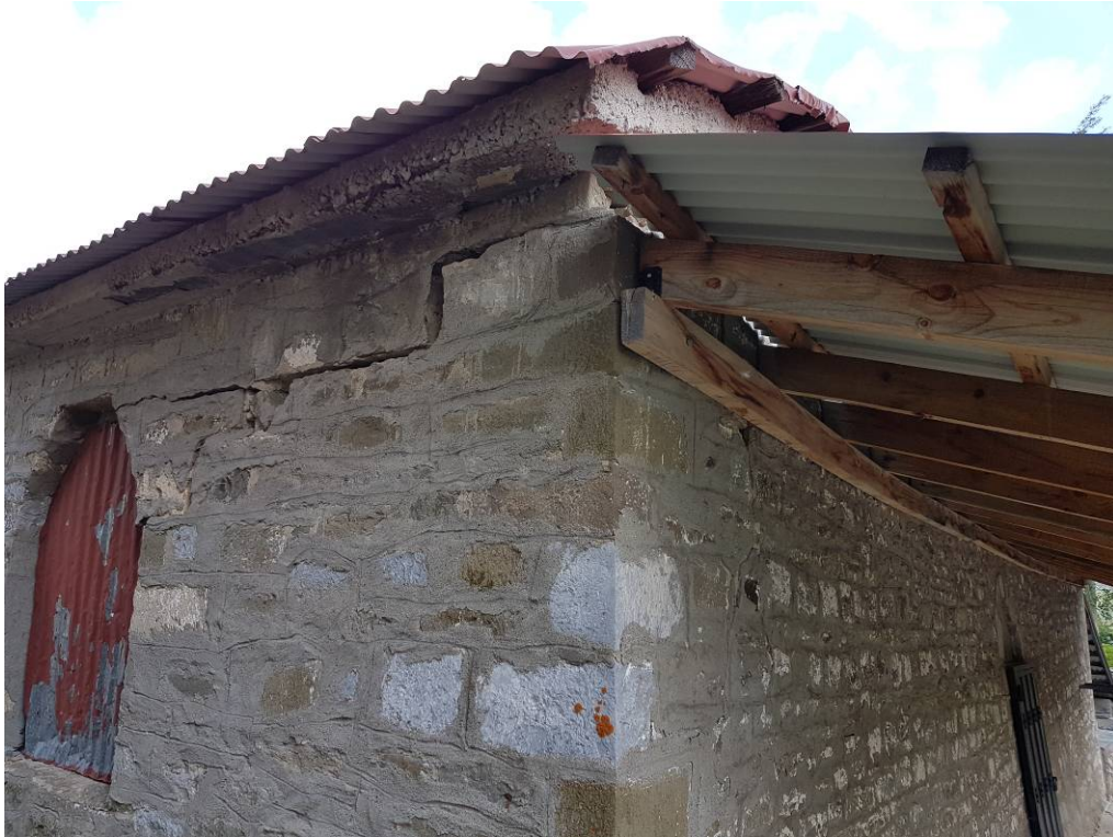
Ε.10.03. Ρηγματώσεις στο βορινό τοίχο
