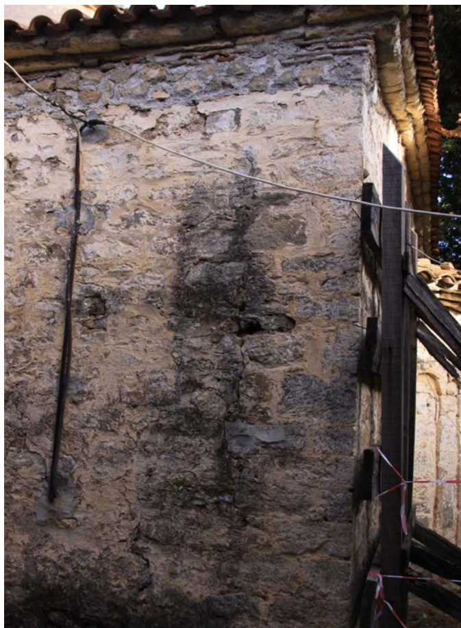
Ε.01.10. Κατακόρυφη ρηγμάτωση στην νοτιοανατολική γωνία
