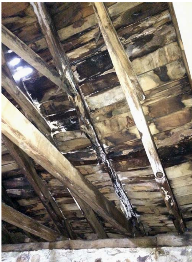
Ε.30.06. Αποσάθρωση αμείβοντα και πετσώματος
