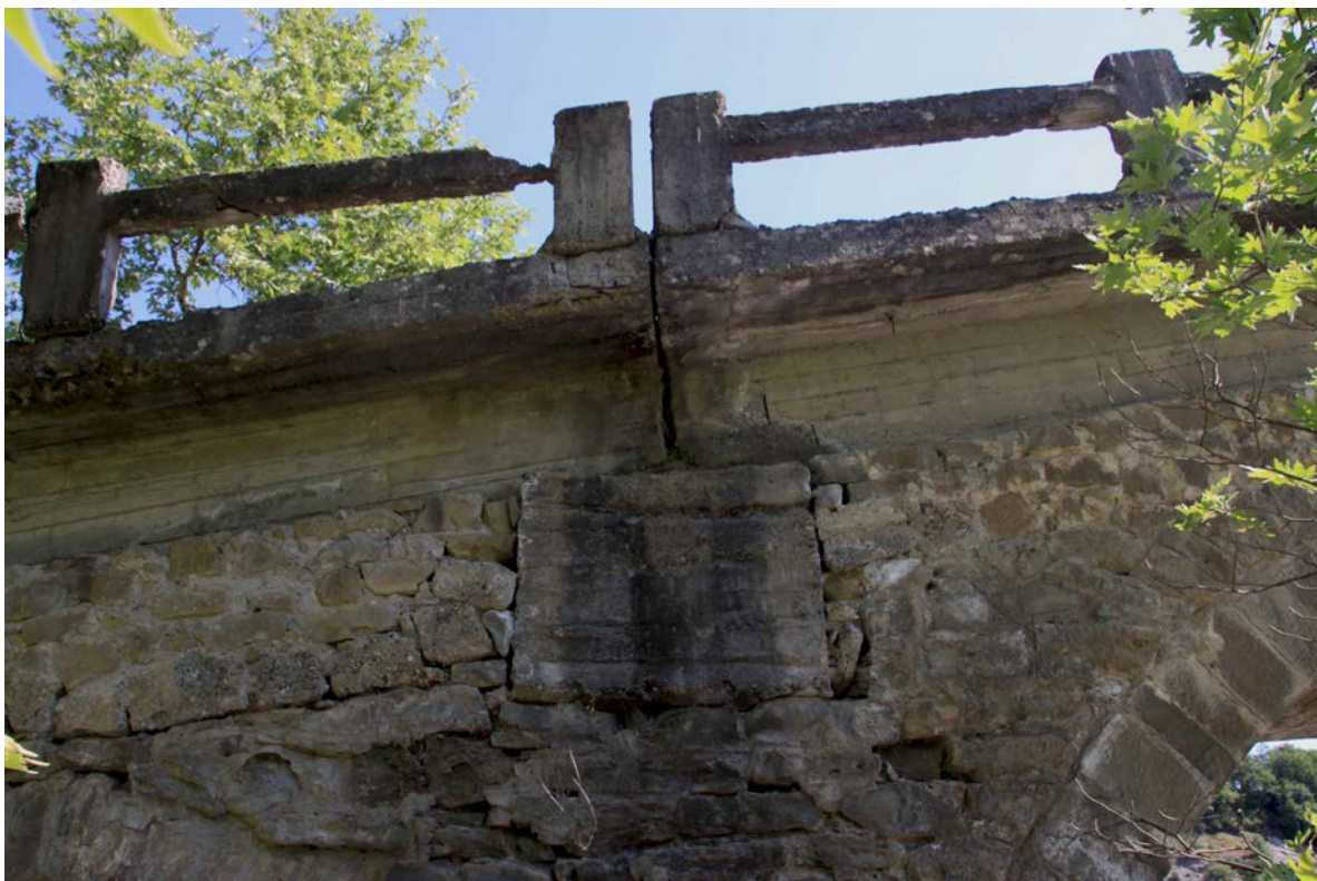
Γ.05.04. Κατάστρωμα από σκυρόδεμα -νεότερη επέμβαση χωρίς συνάφεια με τα υφιστάμενα λιθοσώματα
