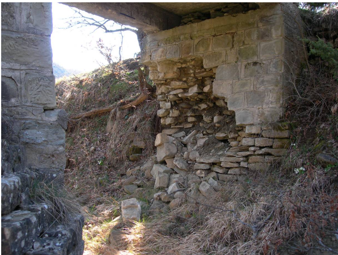
Γ.03.06. Αποσάθρωση νότιου πρανούς
