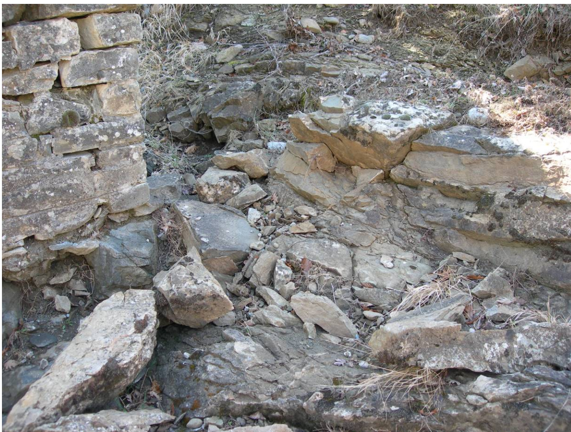
Γ.03.08. Αποσάθρωση βράχου νότιου πρανούς
