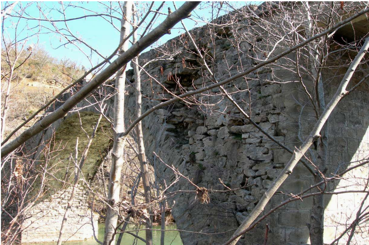
Γ.03.10. Απώλεια λιθοσώματος και κονιάματος δόμησης στο κατάστρωμα από επιρροή ομβρίων
