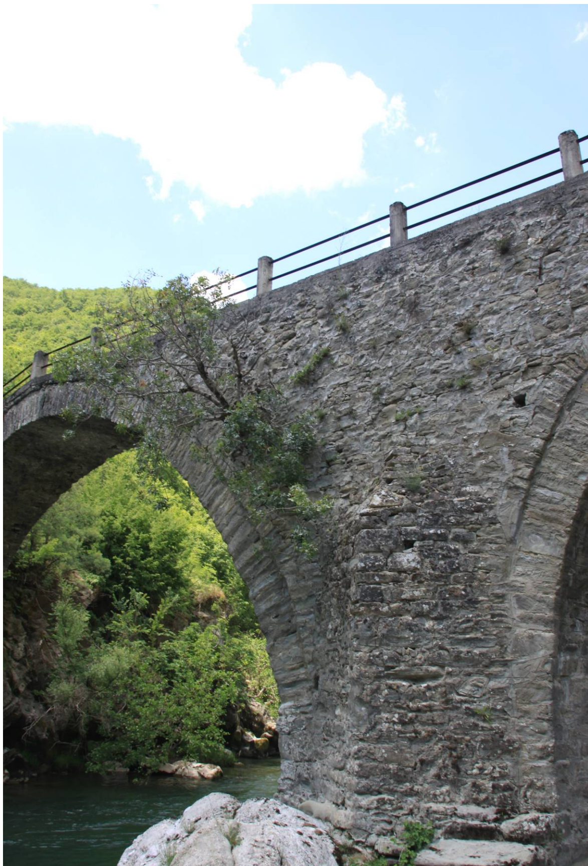
Γ.02.04. Ανατολική όψη (κατάντη) του μεσοβάθρου όπου εντοπίζεται η ύπαρξη δέντρου και βλάστησης στην ανωδομή
