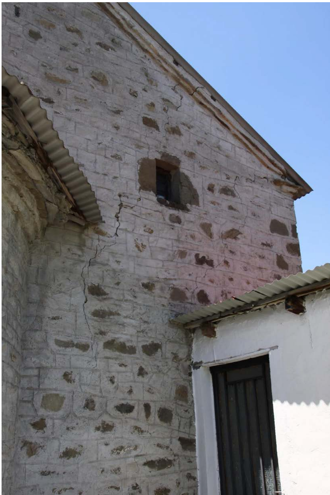
Ε.19.02. Ρωγμές στον ανατολικό τοίχο γύρω από άνοιγμα
