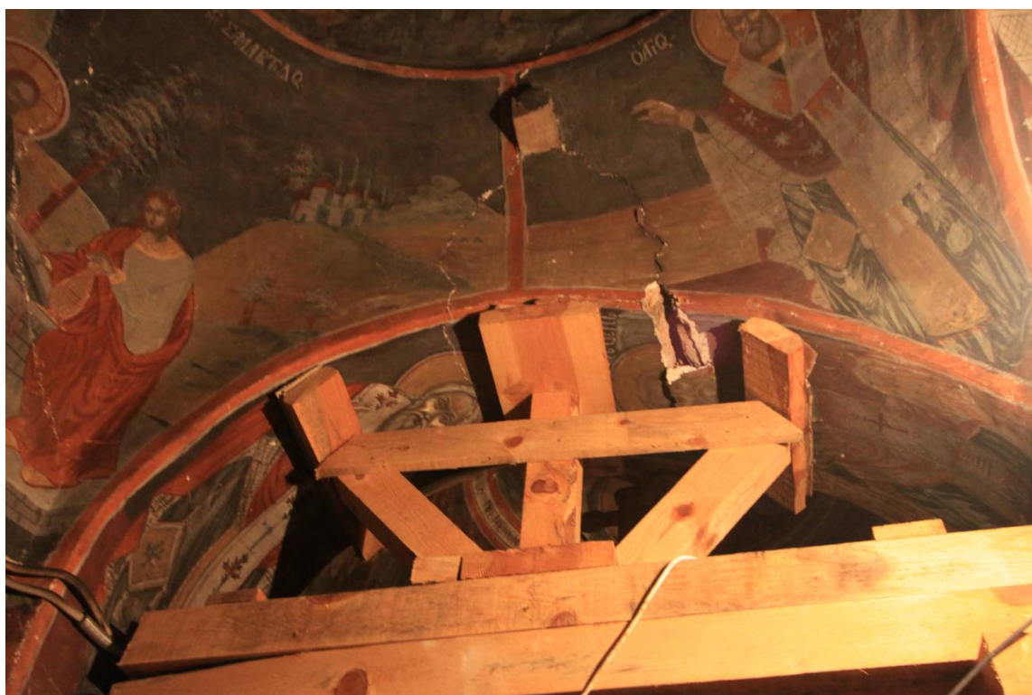
Ε.01.08. Κομμένοι ελκυστήρες στον τρούλο
