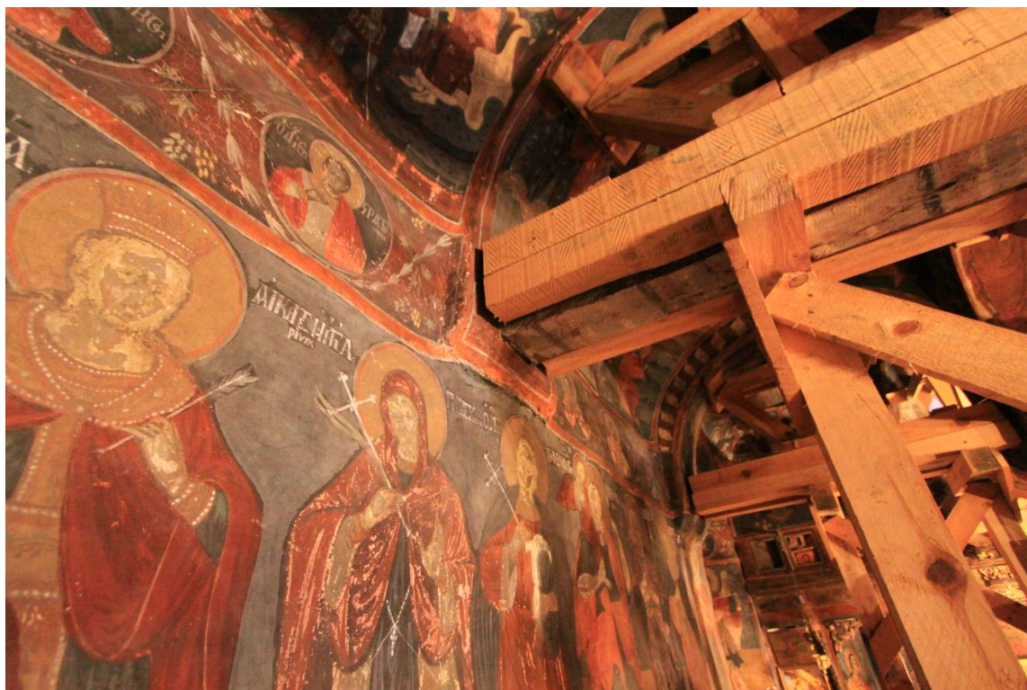
Ε.01.09. Ολίσθηση ελκυστήρων στη θέση στηριξής τους στο βόρειο τοίχο
