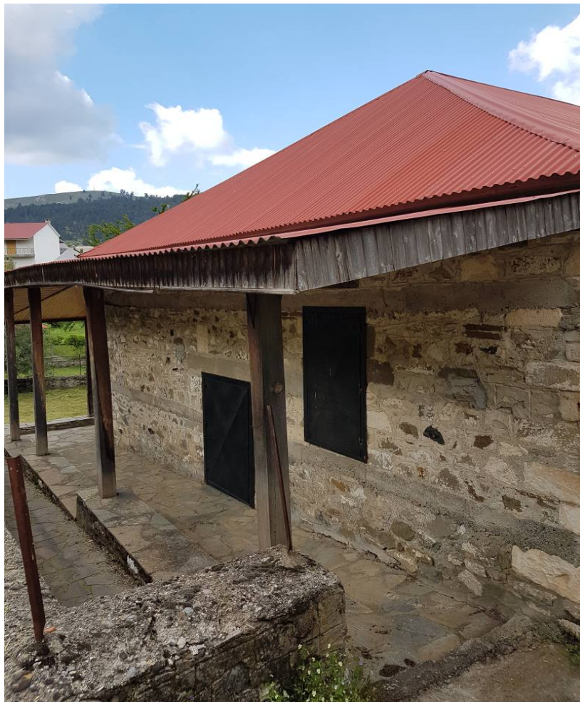
Ε.11.05. Λαμαρίνα στη στέγη
