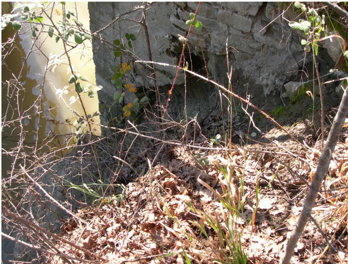
ΠΕΤΡΟΓΕΦΥΡΟ ΡΟΔΟΧΩΡΙΟΥ (ΓΕΦΥΡΙ ΤΟΥ ΤΣΙΟΥΚΑΡΗ) ΒΟΡΕΙΟ ΑΚΡΟΒΑΘΡΟ-ΑΝΑΤΟΛΙΚΗ ΠΛΕΥΡΑ-ΥΠΟΣΚΑΦΗ ΝΕΟΤΕΡΟΥ ΑΚΡΟΒΑΘΡΟΥ ΟΠΛΙΣΜΕΝΟΥ ΣΚΥΡΟΔΕΜΑΤΟΣ ΑΠΟ ΕΠΙΡΡΟΗ ΠΑΓΕΤΟΥ. ΣΥΝΕΧΙΖΟΜΕΝΗ ΦΘΟΡΑ ΠΡΑΝΟΥΣ ΜΕ ΜΕΛΛΟΝΤΙΚΕΣ ΣΥΝΕΠΕΙΕΣ
