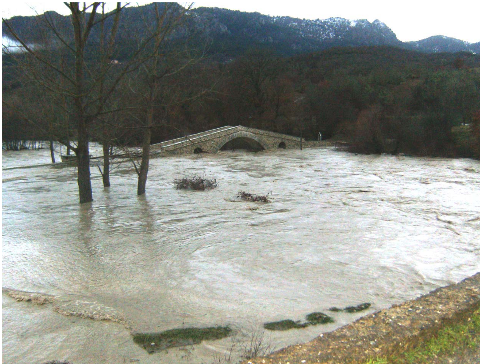
ΥΠΕΡΚΑΤΑΠΟΝΗΣΗ ΠΕΤΡΟΓΕΦΥΡΟΥ ΖΙΑΚΑ (ΜΕΤΑ ΤΗΝ ΑΠΟΚΑΤΑΣΤΑΣΗ ΤΟΥ) ΑΠΟ ΤΙΣ ΠΛΗΜΜΥΡΕΣ ΤΟΥ 2009
