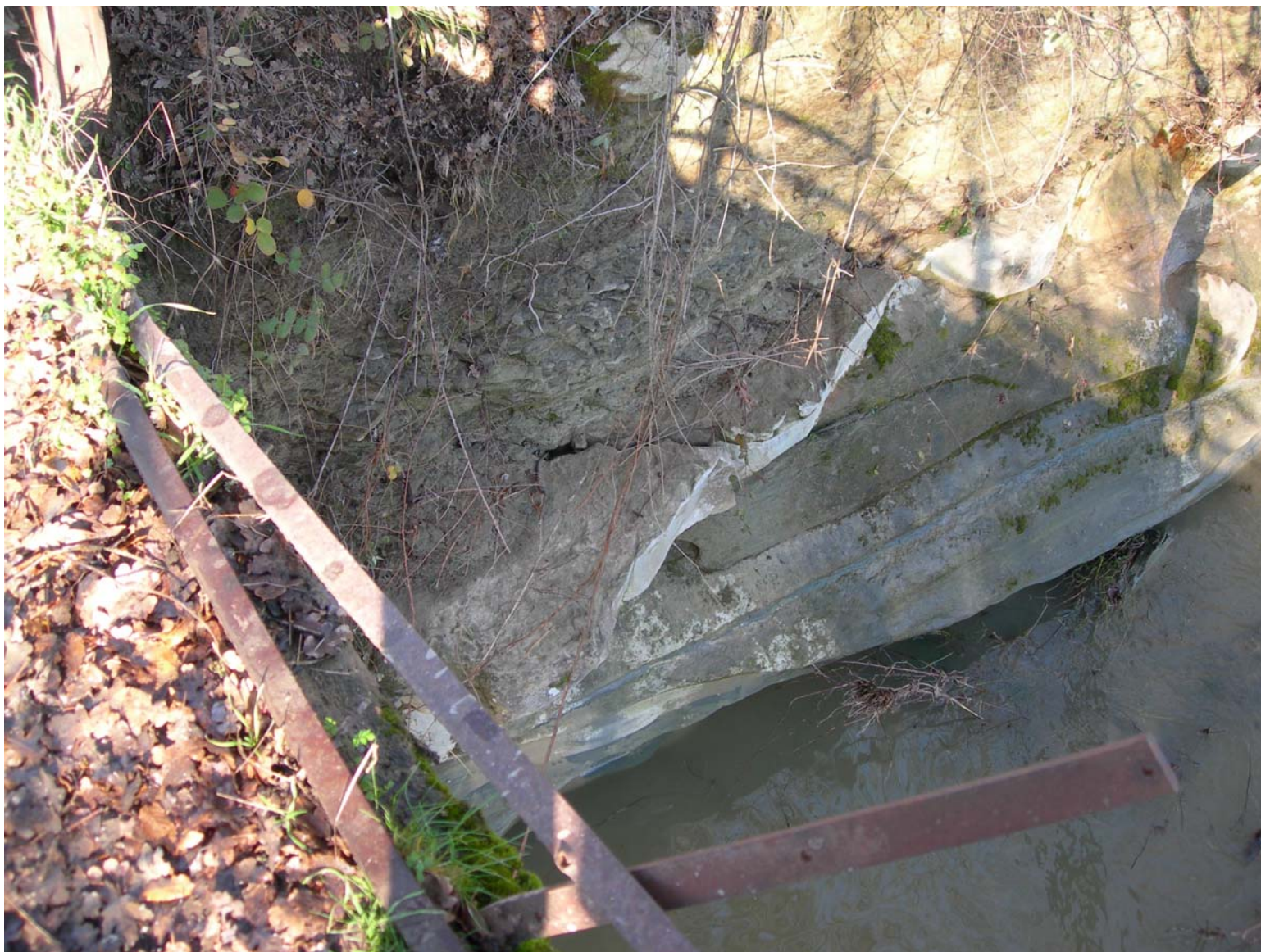
ΠΕΤΡΟΓΕΦΥΡΟ ΡΟΔΟΧΩΡΙΟΥ (ΓΕΦΥΡΙ ΤΟΥ ΤΣΙΟΥΚΑΡΗ) ΒΟΡΕΙΟ ΑΚΡΟΒΑΘΡΟ-ΑΝΑΤΟΛΙΚΗ ΠΛΕΥΡΑ-ΡΗΓΜΑΤΩΣΗ ΚΑΙ ΘΡΥΜΜΑΤΙΣΜΟΣ ΒΡΑΧΟΥ-ΜΗ ΑΠΟΡΡΕΟΥΣΕΣ ΔΙΑΚΛΑΣΕΙΣ ΒΡΑΧΟΥ ΠΡΟΣ ΤΗΝ ΚΟΙΤΗ ΤΟΥ ΠΟΤΑΜΟΥ
